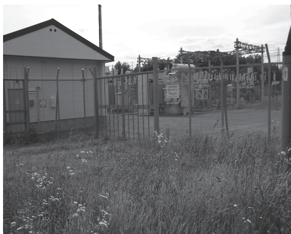
北電の変電所
