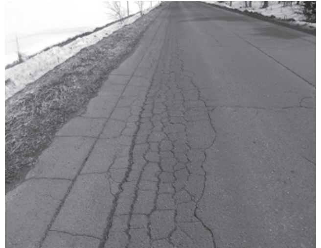
損傷がみられる町道舗装
