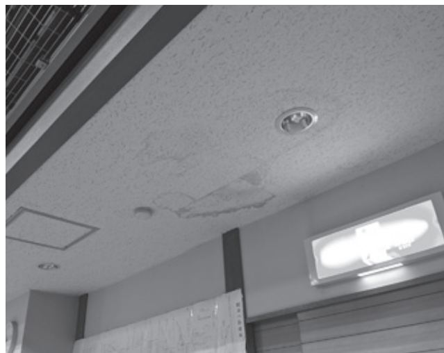
改修が必要な天井の雨漏りの跡
