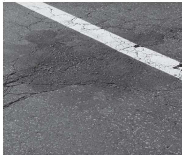
経年劣化の見られる町道
