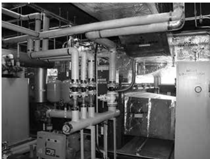
役場庁舎のボイラー
