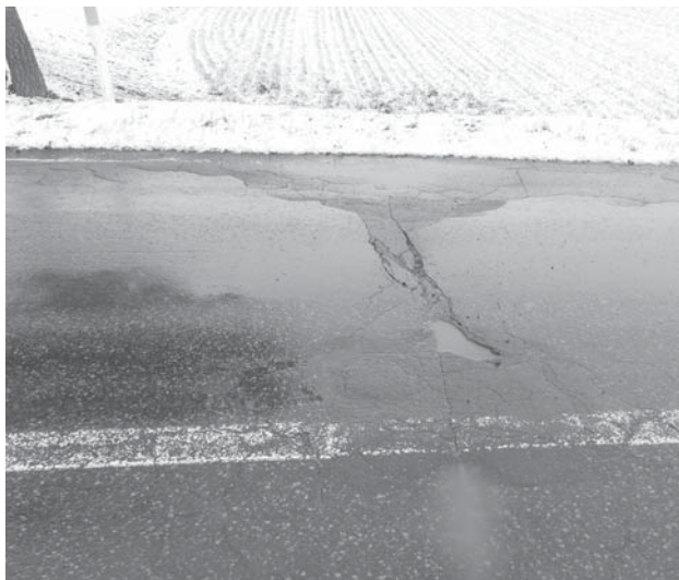
早期改修が望まれる町道
