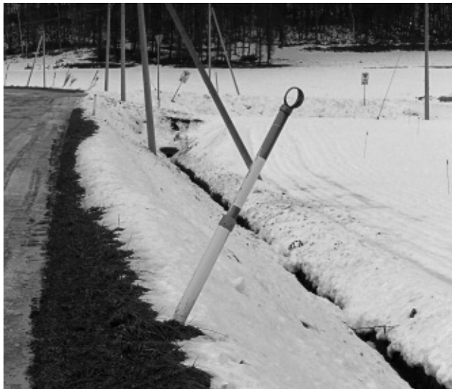
破損状態のデリネーター
