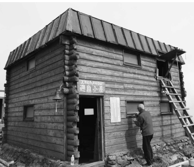
老朽化している現在の避難小屋
