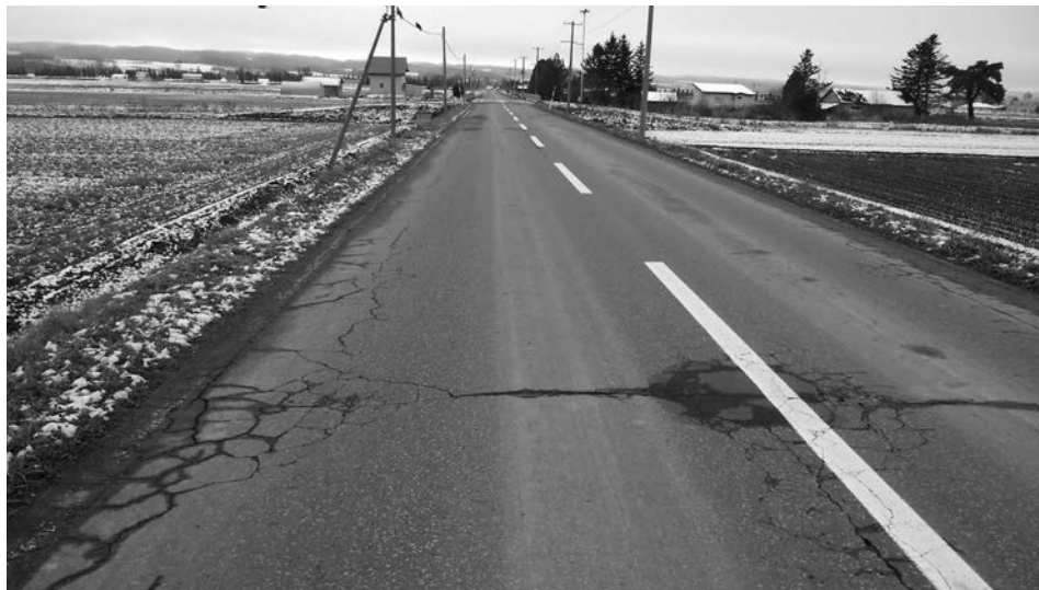
劣化している町道
