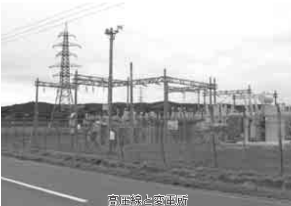
高圧線と変電所
