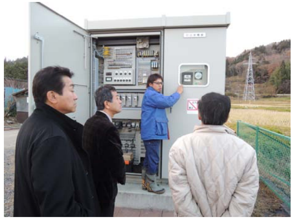
【照井土地改良区の小水力発電の現地説明】
