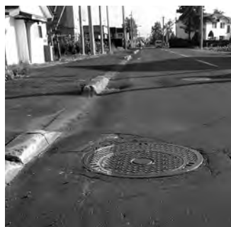
町道のマンホール段差部分
