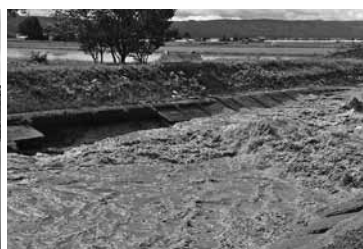
激流により護岸が破損
