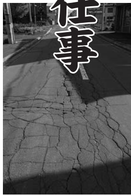
ひび割れた道路。年次的に整備を行います…
